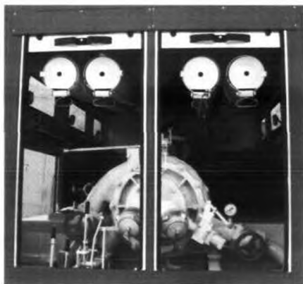
Пожарный насос ПН-110
