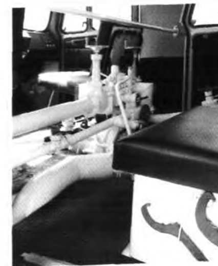
Пожарный насос НЦП-40/100 в КБР
