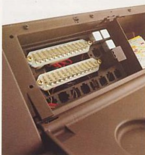
Het zekeringskastje – overzichtelijk en gemakkelijk bereikbaar.
